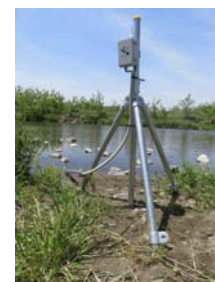
単管固定設置 水位観測
