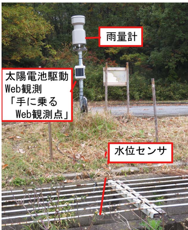
水位と雨量の観測システム
