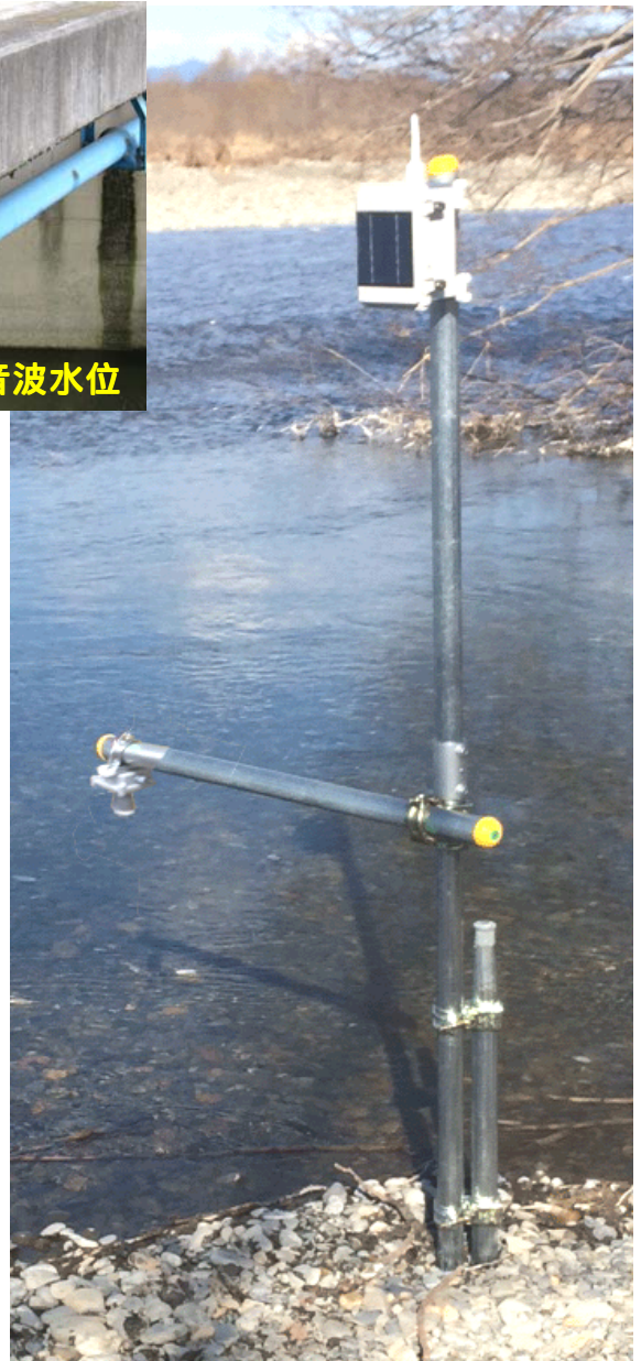
分離型 超音波水位観測
