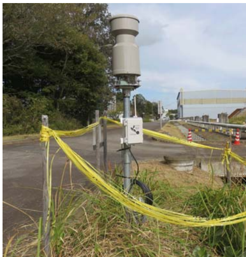
LoRa 水位・雨量観測システム
